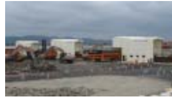
完成した混合廃棄物破砕選別設備
